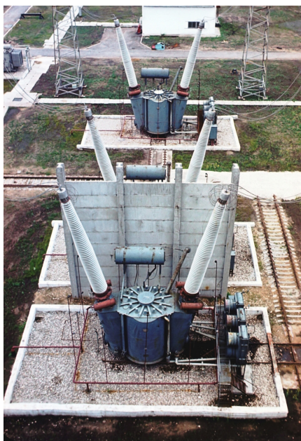
Рис. 3. Шунтирующий реактор для ВЛ 1150 кВ на испытаниях
