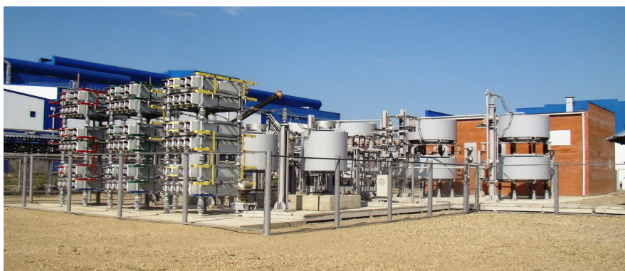
Рис. 7. ООО «АЭМЗ», г. Абинск, СТК 35 кВ 180 Мвар для ДСП 130 МВА и АПК 24 МВА
