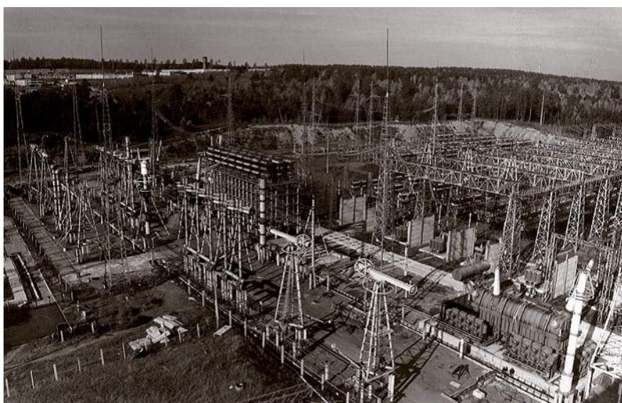
Рис. 1. Мощный испытательный стенд в г. Тольятти на напряжение 500-1150 кВ
