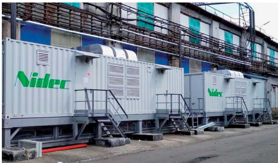
Рис. 10. Два СТАТКОМа 6 кВ, 0 – 8 Мвар в контейнерном исполнении на площадке Новокузнецкого металлургического комбината
