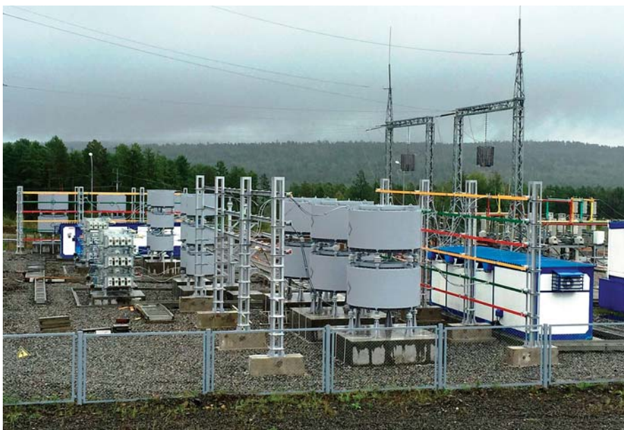
Рис. 7. Общий вид двух СТК на подстанции НПС-21 «Сковородино»
